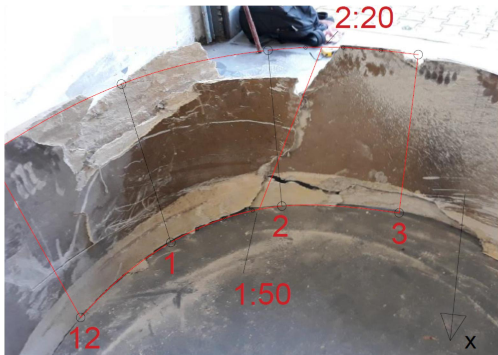
Rys. 12. Widok na wewnętrzną powierzchnię Łącznika w miejscu rozerwania; na górze czoło Łącznika od strony rury stalowej (20191216_142242).
