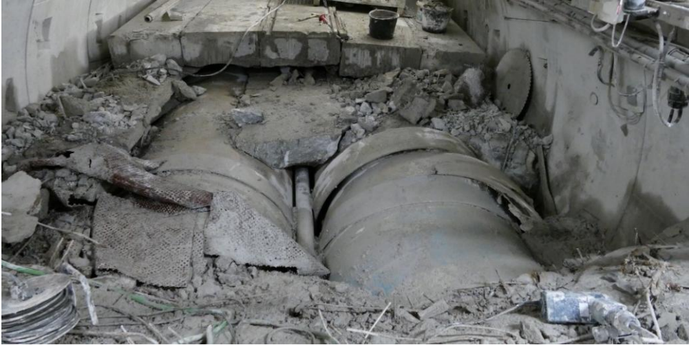
Rys. 7. Odsłonięte miejsca połączeń rurociągów z rur GRP z rurociągami stalowymi. Po prawej – nitka A i rozerwany rurociąg z rury GRP (Łącznik) [5].
